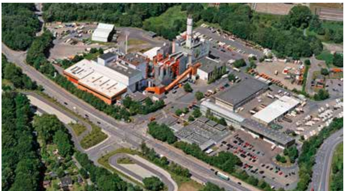
Rückbau der Müllverwertungsanlage Stelling Moor: Hier errichtet die SRH in den kommenden Jahren das Zentrum für Ressourcen und Energie (ZRE), ein deutschlandweit bislang einzigartiges Vorzeigeprojekt für die Abfallbehandlung der Zukunft.
